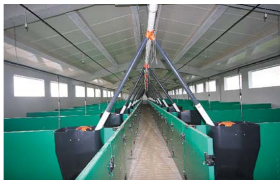
Figura 28. Ejemplo de cebadero con un pasillo central y dos filas de cuadras.
