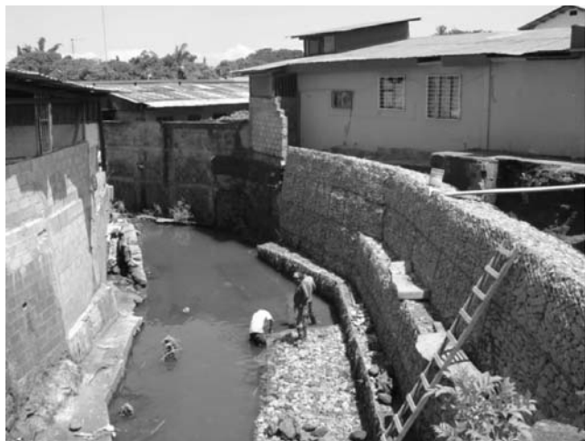
Fotografía 1.- Construcciones habitaciones dentro del cauce Burío Quebrada Seca. Fuente: Comunidad de Belén. CIMH (2006)
